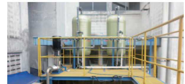
雨水利用設備(インドネシア工場)
